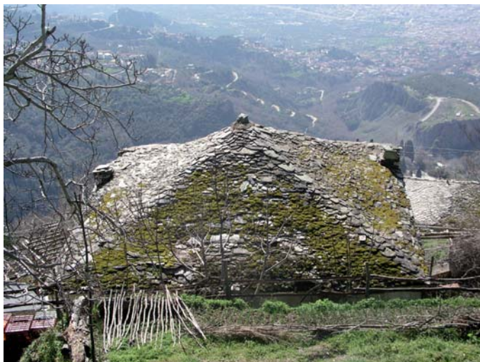
Εικόνα 44. Μακρινίτσα. Βρύα πάνω στη ΒΔ πλευρά στέγης.
