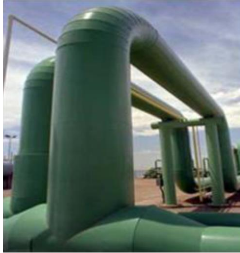
Εικόνα 15: Μεταφορά υδρογόνου σε αγωγούς (πηγή: U.S. Department of Energy Hydrogen Program ).
