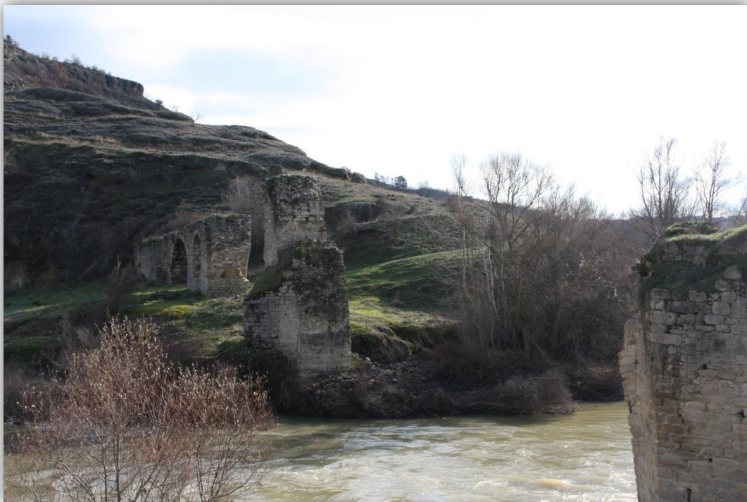
Εικόνα 60: Ερείπια του γεφυριού του Πασά, Πηγή: Κ.Π.Ε Γρεβενών (2012)
