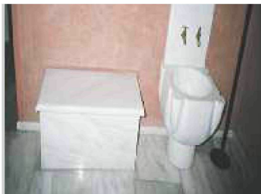
Εικόνα 5 Κάθισμα και Νιπτήρας με θερμό νερό για άνδρες
