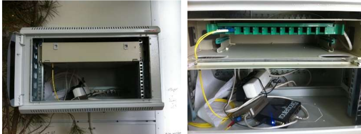
Εικόνα 7. Rack τερματισμού οπτικής ίνας και CPE σε σχολική μονάδα Μυτιλήνης
